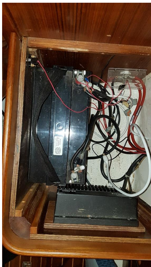
Låda vid mast innan byte.
